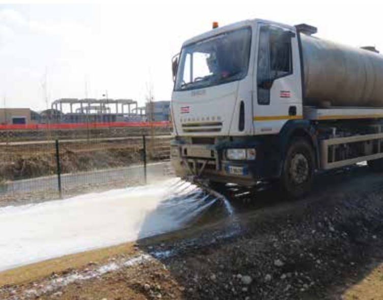
1. L'asperisione in Top Coat del Soil Sement su un terreno stabilizzato a cemento
